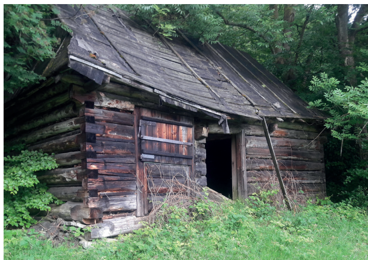
Rycina 2. Zniszczona infrastruktura pasterska pod Halą Romanka (fot. R. Karpeta)
