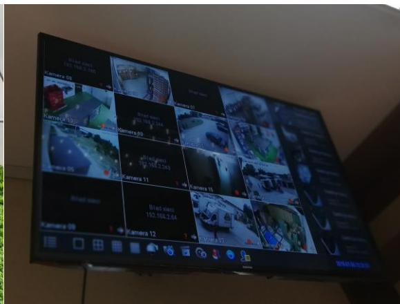
Zdjęcie 3.4. Monitoring wizyjny
