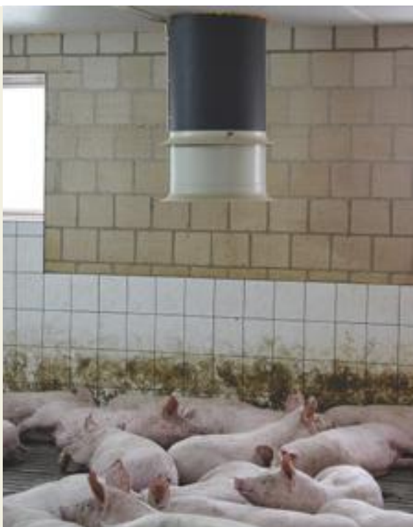
Fotografia 4.3. Wentylacja mechaniczna (fot. A. Dudek)
