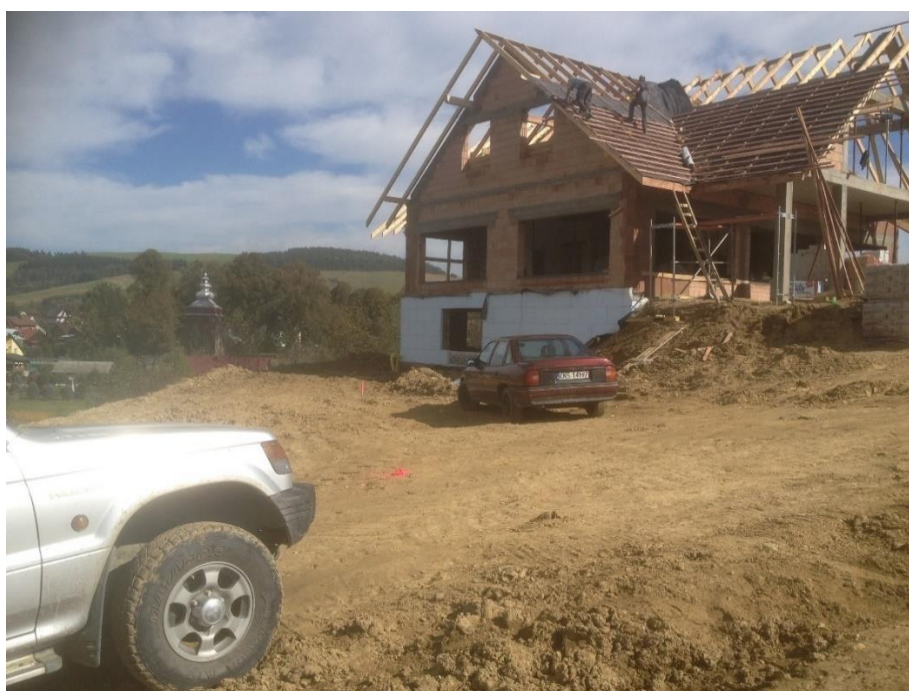
Ryc. 47. Budowa karczmy na stacji narciarskiej Master-Ski. Źródło: fot. udostępnione przez właścicieli stacji narciarskiej Master-Ski.
